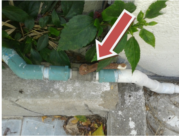
หมายเลข 12 วาล์วควบคุมน้ำประปาเข้าแท็งก์หอพักนักเรียนหญิง 7 อยู่บริเวณด้านหลังหอพักนักเรียนหญิง 7 (ตึกรั้วหลัง โรงเรียน)
