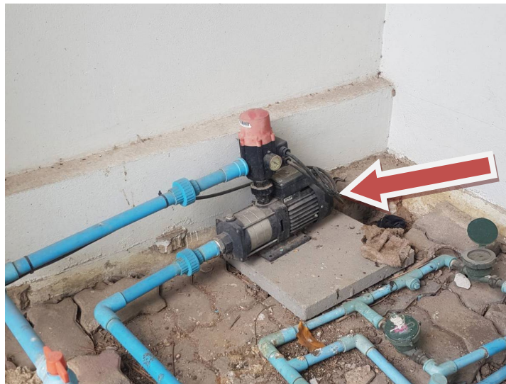
P8 ปัมป์สูบน้ำบ้านพักผู้อำนวยการ ติดตั้งอยู่บริเวณด้านหลังบ้านพักผู้อำนวยการ
