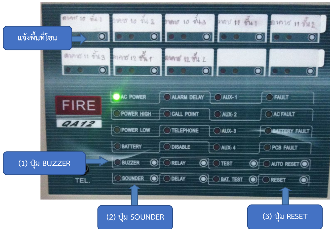
ตำแหน่งบอกปุ่มเปิด-ปิดระบบแจ้งเตือน อาคาร 10-11-12
