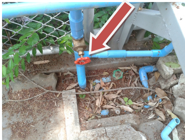
หมายเลข 13 วาล์วควบคุมน้ำประปาบ้านพักผู้อำนวยกา อยู่บริเวณด้านหลังบ้านพักผู้อำนวยกาติตริ่วหลัง โรงเรียน
